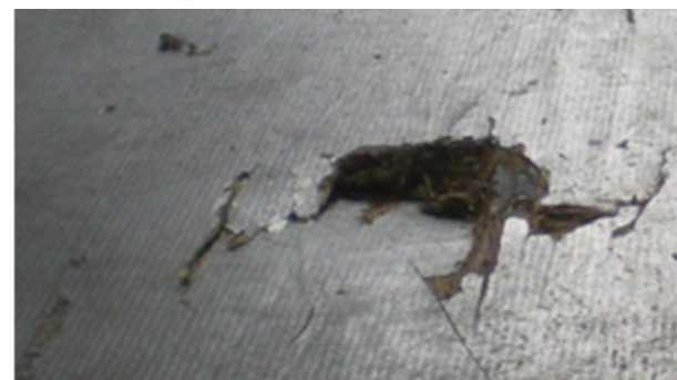
🔧 Pavimentos: deformações ou perfurações dentro da reparação económica
