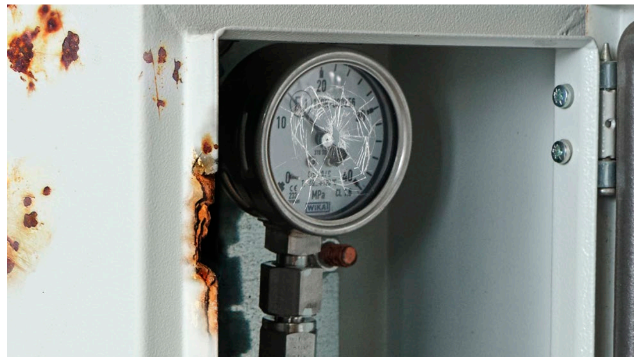
Chave da caixa de proteção em falta, manómetro ou recipiente GNC danificado → cobrança da substituição da caixa completa.
