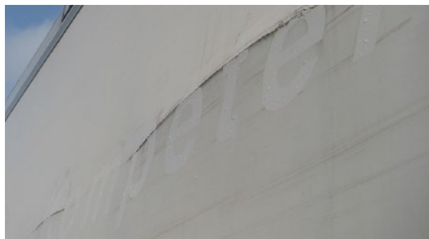
↻ Painéis laterais em fibra: deformação na parte inferior, comprimento > 1 m
