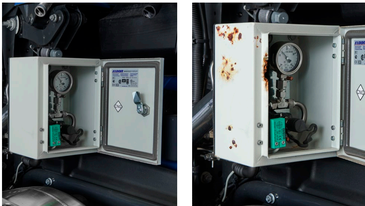
Ferrugem na caixa de proteção da tomada de enchimento → nota sem cobrança por dano.
